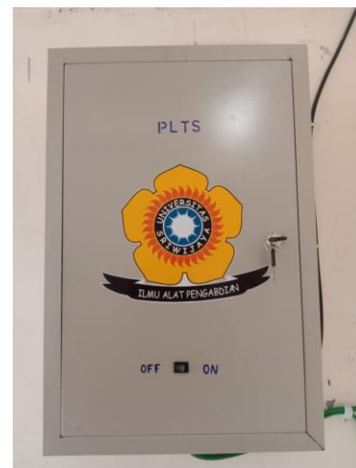
Gambar 4. Panel konverter PLTS dan PLN di Masjid Aqobah
