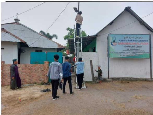
Gambar 6 Lampu PJU dipasang di depan gedung Ponpes Darussalam Al-Fatah
