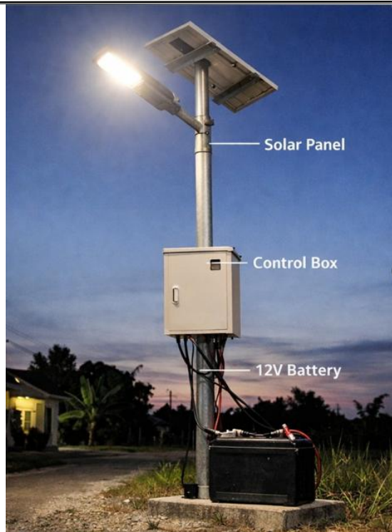
Gambar 3. Sistem PJU Setelah Implementasi
