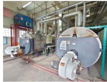
Gambar 2. Unit Boiler Hoval RSUP Dr. M. Djamil Padang
