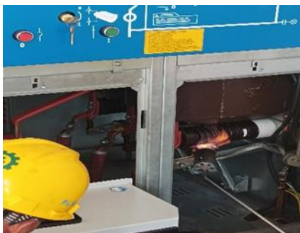
Gambar 6. pembakaran cairan elektrik atau pengeringan kompartemen kubikel
