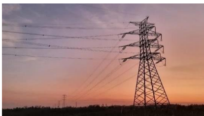
Gambar 1. SUTT (Saluran Udara Tegangan Tinggi) 150 kV [11]
