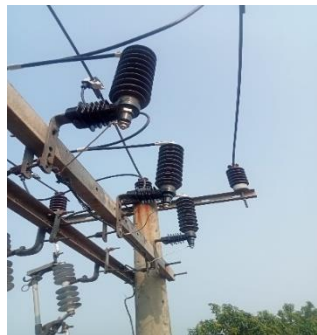
Gambar 5. Setelah Penggantian Arrester
