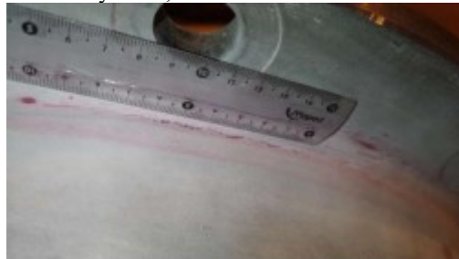
Gambar 7. Retakan linear pada sambungan las riser pipe 1
