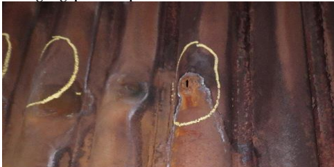
Gambar 7. Bulging pada pipa boiler
