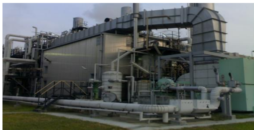
Gambar 4. Boiler di RU VI Balongan
