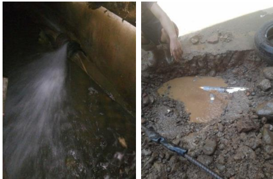
Gambar 4. Temuan Kebocoran di DMA Pondok Mutira
