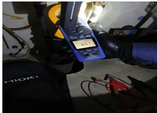
Gambar 3. 3 Pengukuran Arus Fasa S WBP
