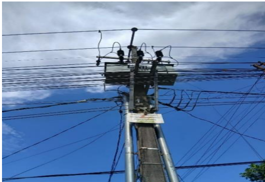
Gambar 3. 5 Transformator 50 kVA Distribusi PLTT230
